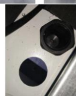
Detail huidige aanwezige wartel !
