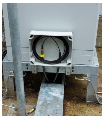
Figuur 5-24 Gas- en waterblokkade in KOK.
